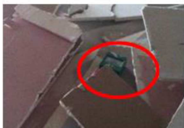
Interrupteur d'alarme incendie oublié
