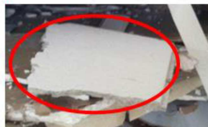
Morceau de plafond suspendu
